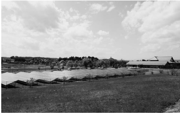
小川福祉センター防災型太陽光発電施設
