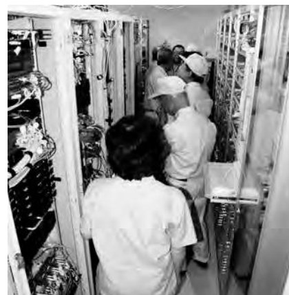
ケーブルテレビ放送センター 機器更新の調査
