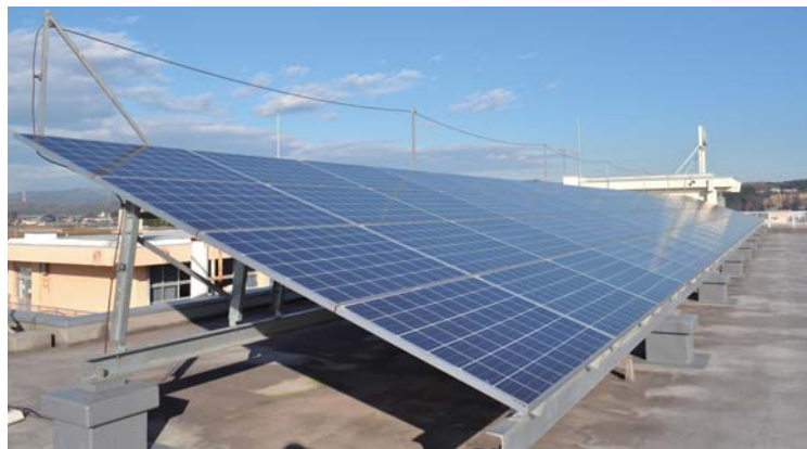
小川中学校の屋上に設置した「太陽光発電システム」
